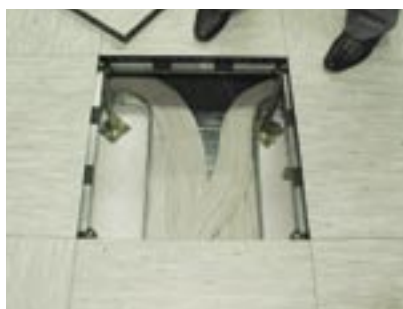
Подпольные коммуникации обеспечивают связь между площадками ЦОД и между соседними шкафами
