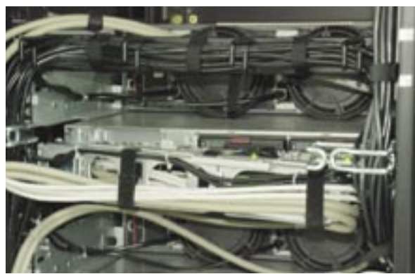
Кабельная разводка в шкафу с активным оборудованием
