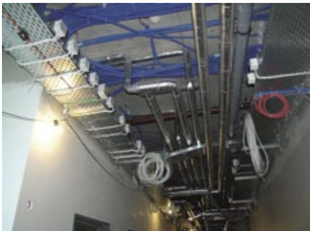
Кабельные и иные коммуникации в одном из коридоров госпиталя
