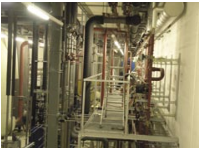
Подземные коммуникации кантонального госпиталя в Цуге
