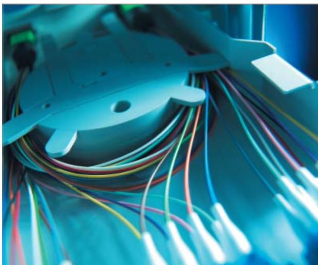
Качества претерминированной сборки, изготовленной и протестированной в заводских условиях, невозможно достичь, собирая решение из компонентов на объекте
