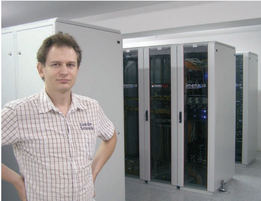
Рис. 7. Сергей Полищук, директор по развитию компании Imena.UA/MiroHost, на фоне заполненных шкафов дата-центра
