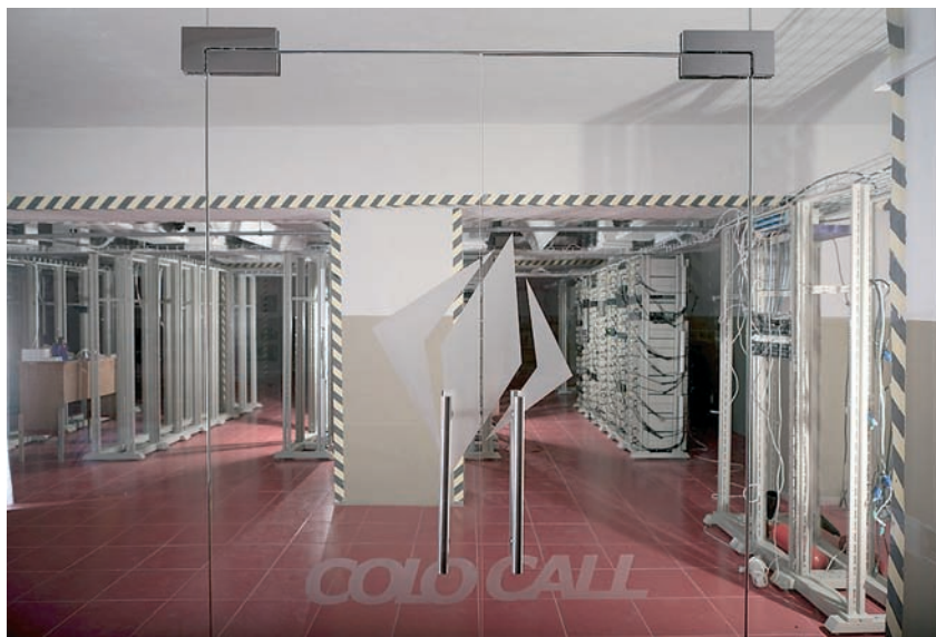
Рис. 6. Новый ЦОД компании «Колокол» размещен в подземном бункере
