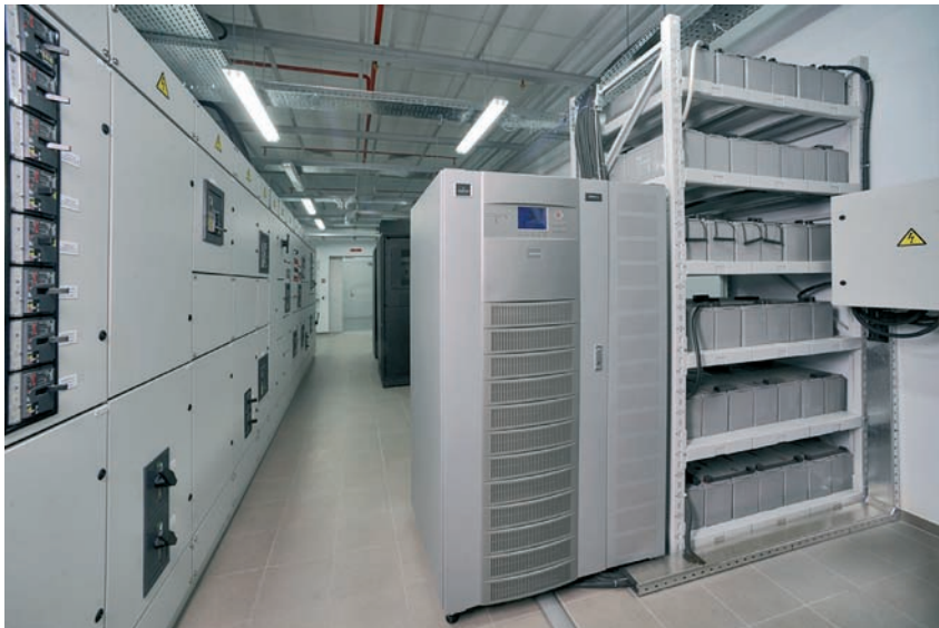
Рис. 5. ИБП и аккумуляторы дата-центра VeMobile, размещенные в отдельном помещении
