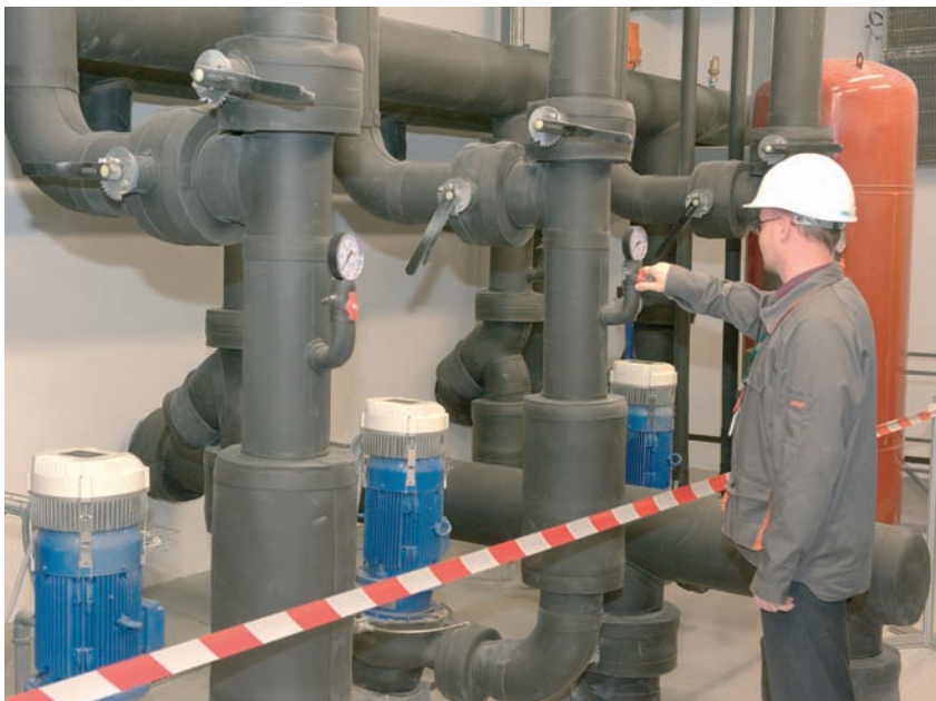
Рис. 3. Фрагмент водяной системы охлаждения дата-центра DeNovo
